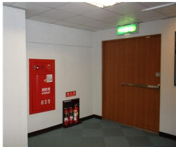
設置於樓梯口旁的消防栓箱
