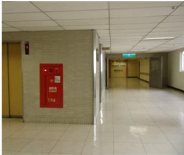
設置於中央電梯旁的消防栓箱
