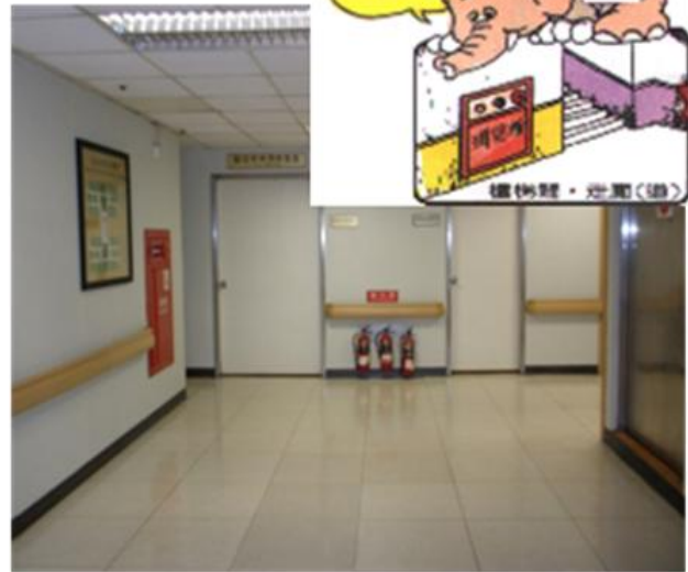
設置於走道旁的消防栓箱
